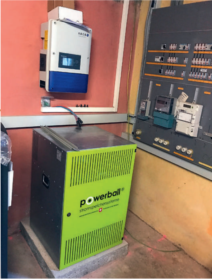
Eine AC-Ankoppelung zeichnet sich durch die hohe Flexibilität aus: Das Speichersystem kann unabhängig von der Photovoltaikanlage installiert werden. Bildquelle: Tritec
